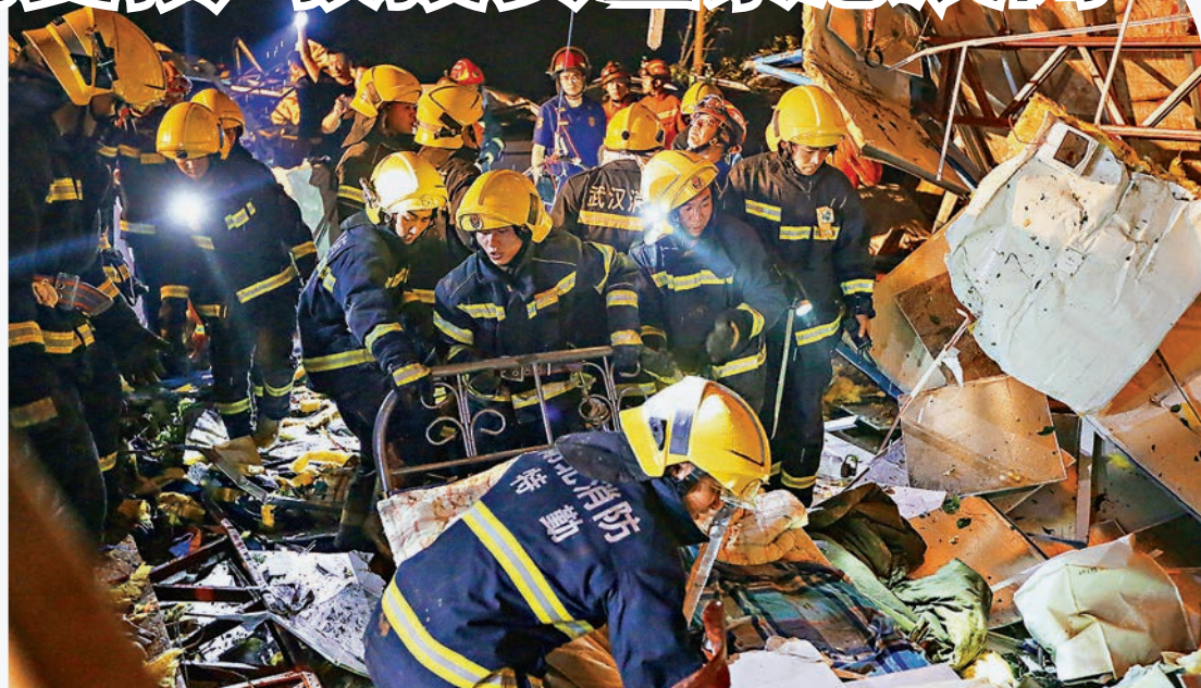
●5月15日，武漢消防救援隊的隊員在武漢市蔡甸區一處被龍捲風颶倒的廠房內搜救。 新華社
