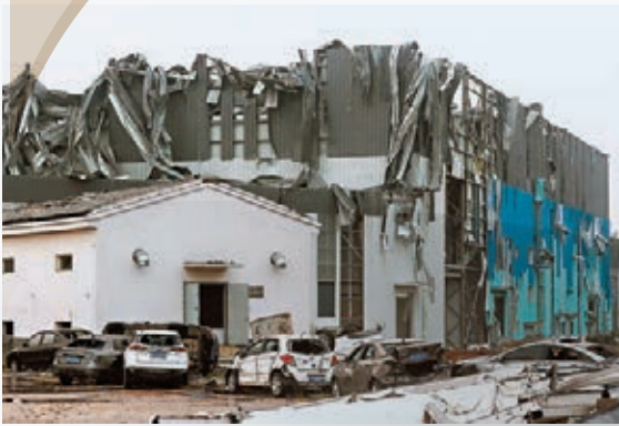
●武漢受龍捲風破壞的車輛廠房。 法新社
