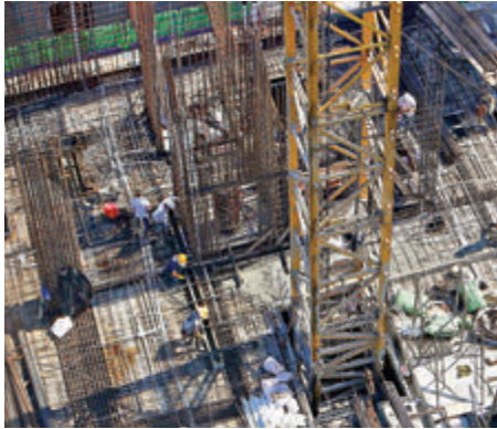
●利嘉閣地產研究部認為，私宅施工量一季2,200伙實不算多。 中通社
