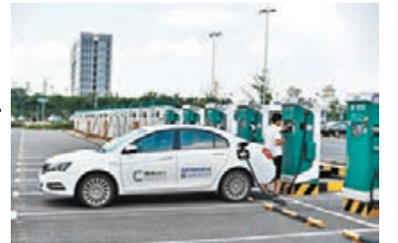
●多地相繼出台建充電樁等政策支持新能源車發展。
