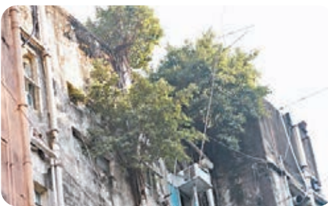
● 有舊樓渠管失修，外牆甚至生樹。資料圖片
