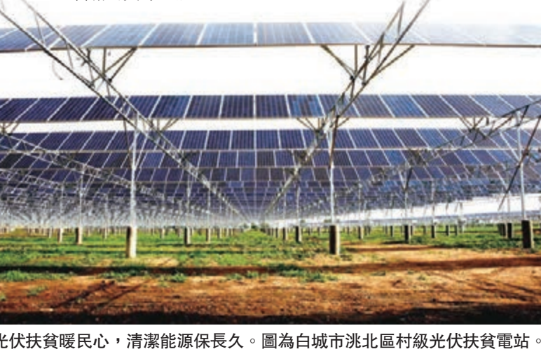
光伏扶貧暖民心，清潔能源保長久。圖為白城市洮北區村級光伏扶貧電站。
