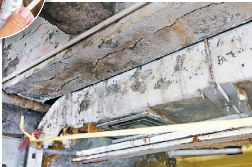
因常年累月漏水，鋼筋生鏽變形，導致橫樑爆裂。
