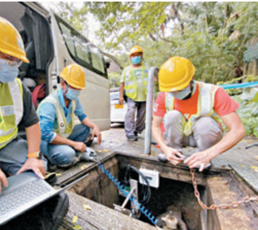
■水務署分析「智管網」收集的水流量等數據，監察供水管網有否出現滲漏。
