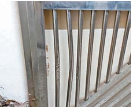
■單位鐵閘及木門仍留有被撬痕跡。香港文匯報記者攝
