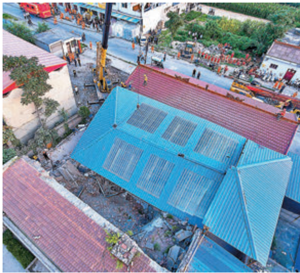
29日9時40分左右，臨汾市襄汾縣陶寺鄉陳莊村聚仙飯店發生部分坍塌，致多人被埋。
