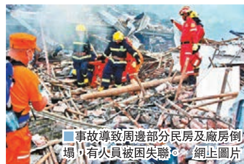
香港文匯報訊 綜合新華社及浙江新聞客戶端，13日16時40分許，G15瀋海高速溫嶺市大溪鎮良山村附近高速公路上，一槽罐車爆炸衝出高速公路，導致周邊部分民房及廠房倒塌。截至20時30分，已造成10人死亡，117人受傷，倒塌房屋內有人員被困失聯。
