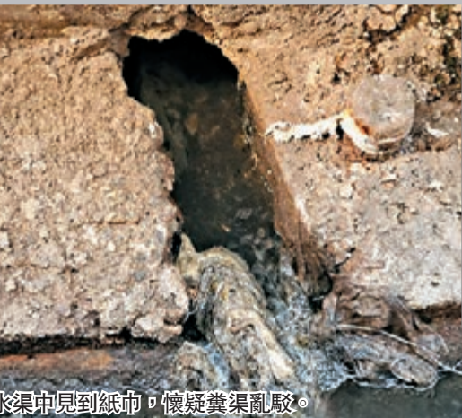
■雨水渠中見到紙巾，懷疑糞渠亂駁。
