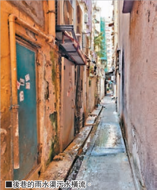
■後巷的雨水渠污水橫流。
