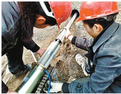
正在蘭渝鐵路邊坡安裝的「基建雲安」監測系統。記者 李兵 攝
