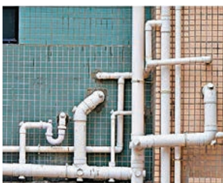
■鼓油街安置大廈翻新工程全面更換大廈喉管以提升衛生水平。網誌圖片
