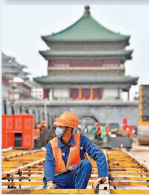
發改委昨日發文表示,要堅持防疫和生產「兩手抓」。圖為西安地鐵六號線施工現場。
