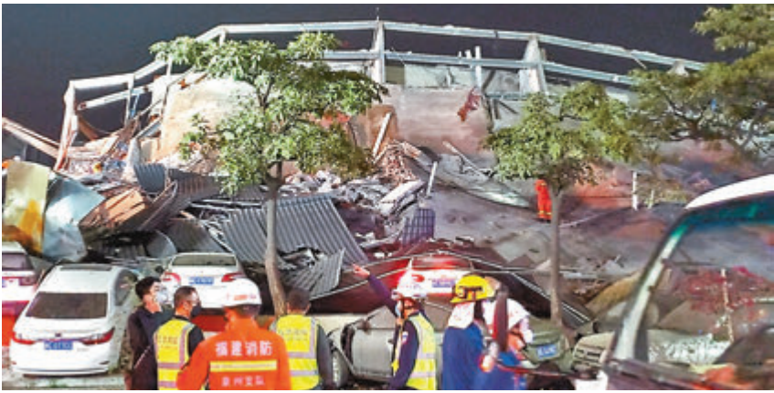
■初步調查結果顯示，該項目存在非法建設、違規改造等嚴重問題。圖為泉州市欣佳酒店「3·7」坍塌事故現場。中新社
