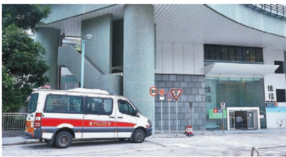
明愛醫院懷明樓一個男廁的尿兜電子沖水感應器有被燒焦痕跡。
