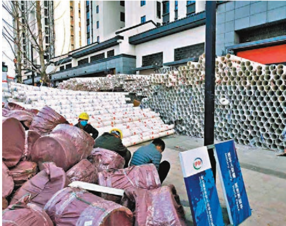
■工人們自願從四方趕來支援雷神山建設，有的甚至只睡兩三個小時。
