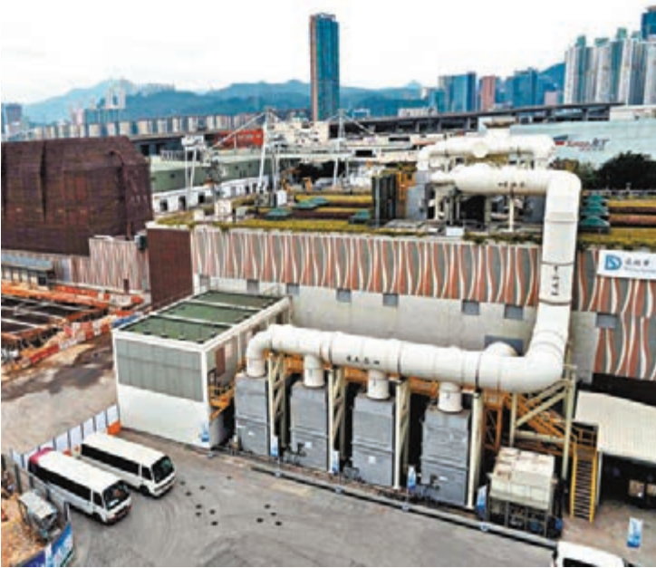
■「淨化海港計劃」因為顧問及承建商遺漏或工程延誤，額外耗資近9億元。 資料圖片
