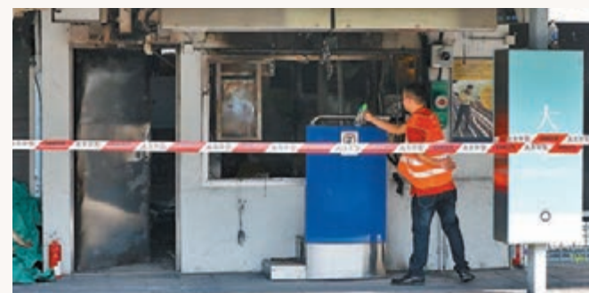
月台上的車站控制室受到打砸及縱火。
