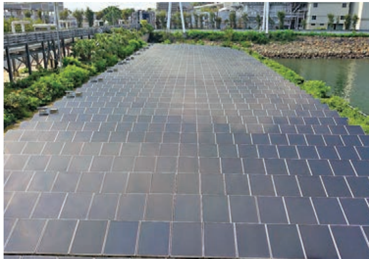
■港燈位於南丫發電廠內的大型太陽能發電系統，系統由八千六百多塊光伏板組合而成。由 2010 年投產至今，已生產的綠色電力，所減少的二氧化碳排放，相等於為香港種超過 31 萬棵樹。作者供圖
