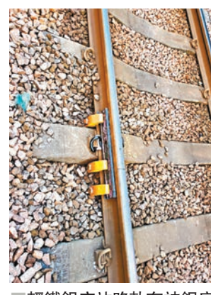
輕鐵銀座站路軌有被鋸痕跡。港鐵圖片
