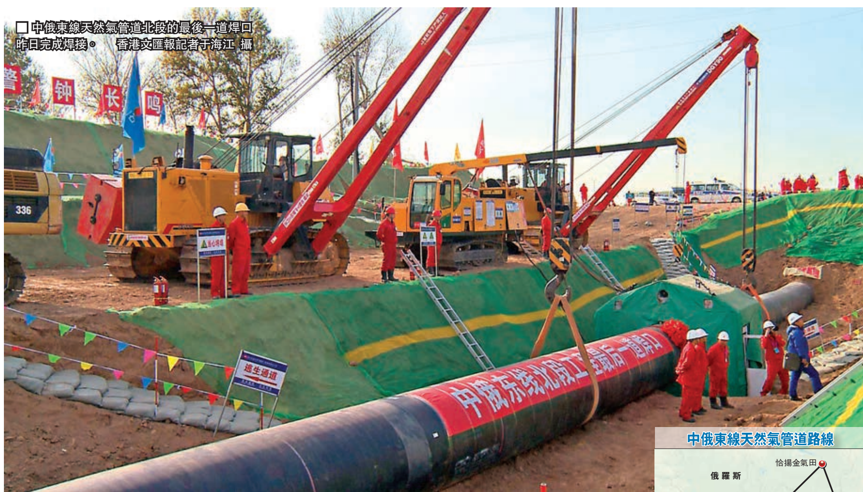
中俄東線天然氣管道北段的最後一道焊口昨日完成焊接。香港文匯報記者于海江攝
