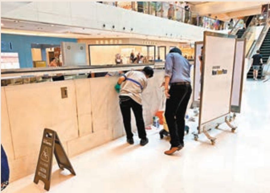
沙田新城市廣場、沙田站暴衝後修復情況。
