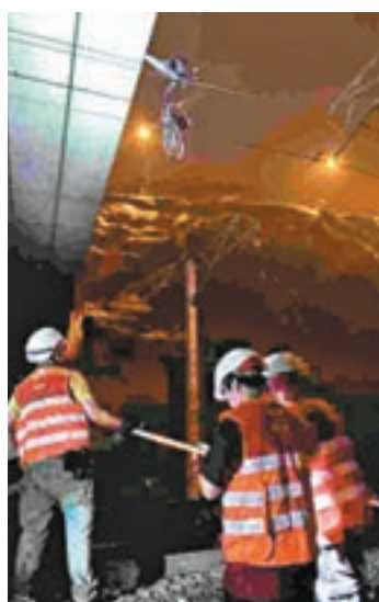
有人將單車掛在東鐵的高壓電纜上。
