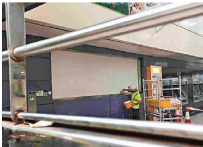
東涌站控制室損毀，工人維修。
