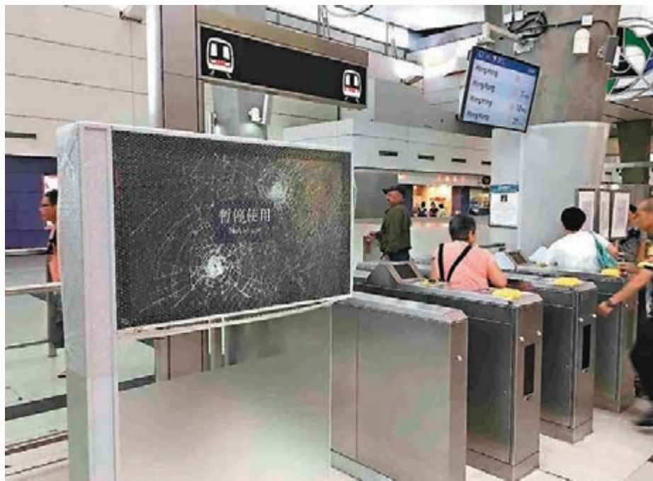
東涌站有顯示屏受破壞。
