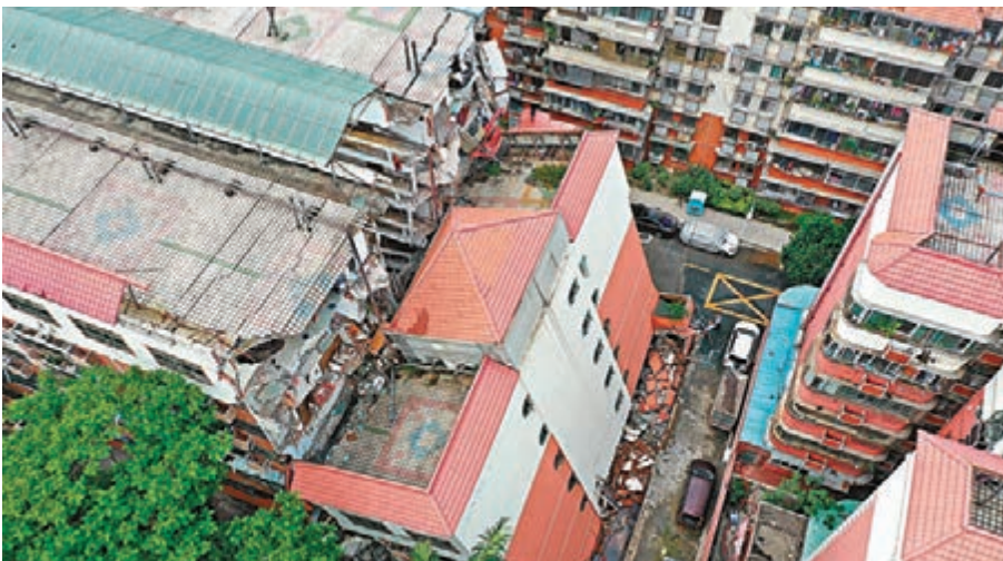
■昨日11時20分許，深圳市羅湖區南湖街道漁邨社區和平新居單身公寓樓發生沉降傾斜，目前無人員傷亡。中新社
