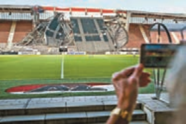
球場上蓋塌下情況。法新社
