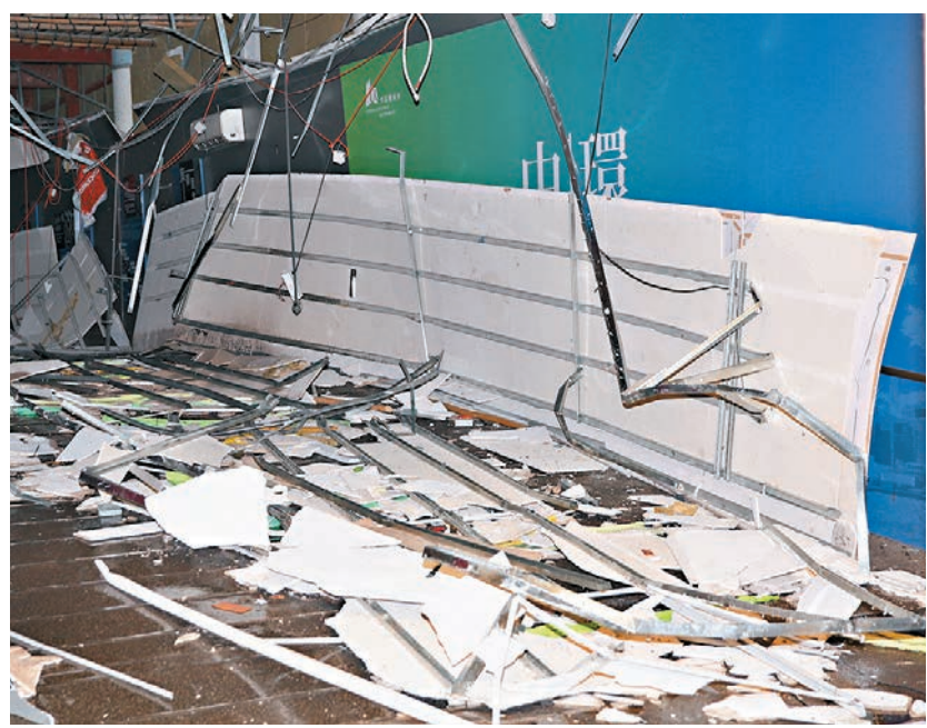
舊中環街市大幅天花塌下。
