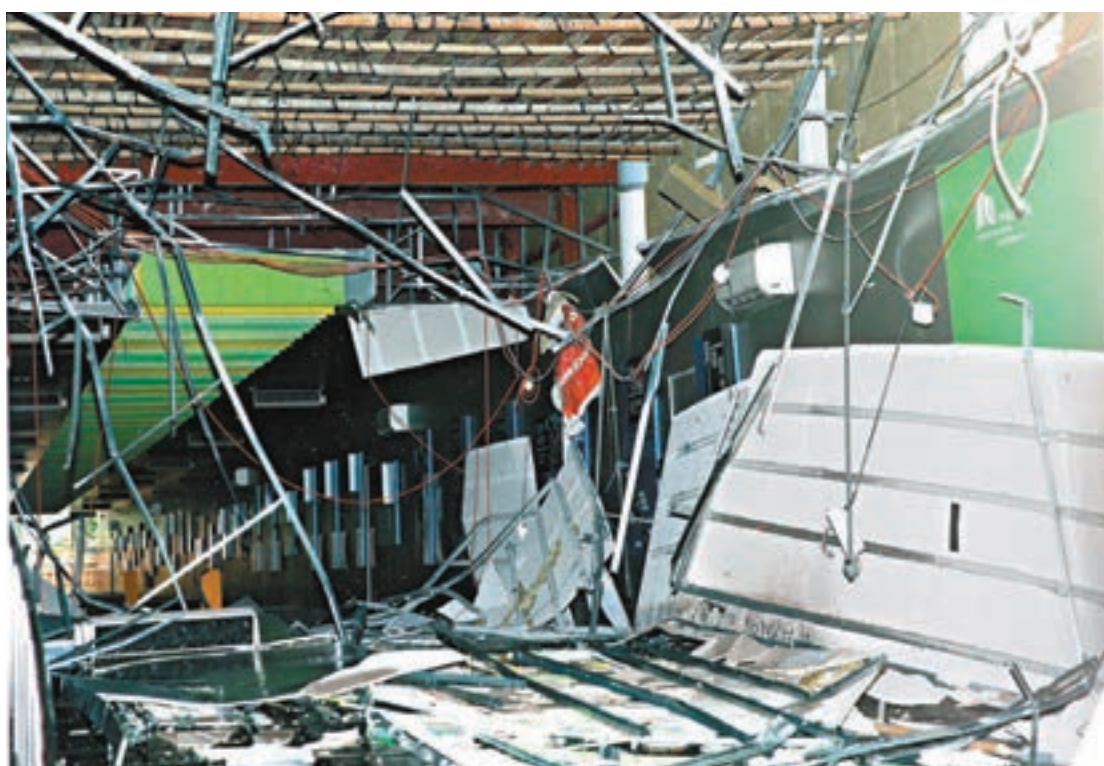
部分支架仍然懸吊在通道頂部。
