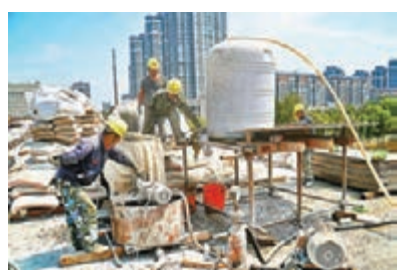
■昨日，工人在江蘇省宿遷市泗洪縣青陽南北大橋改造及城區部分路網提升工程工地上作業。 新華社
