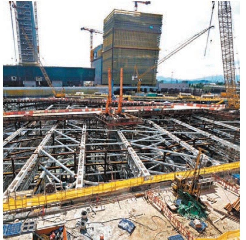
工地的水浸積水至昨日仍未完全抽走。香港文匯報記者梁祖彝攝
