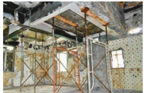
故居內部殘破不堪,只剩下小部分牆身瓷磚及基本鋼筋和水泥牆。業主供圖
