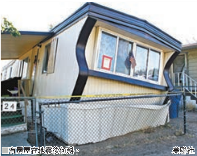
有房屋在地震後傾斜。
