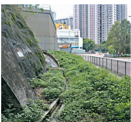
將軍澳翠林體育館附近山坡邊1呎多深的坑渠。
