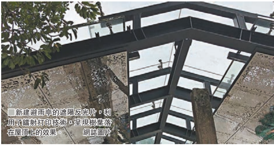
新建避雨亭的遮陽反光片,利用了鐳射打印技術,呈現樹葉落在屋頂上的效果。網誌圖片
