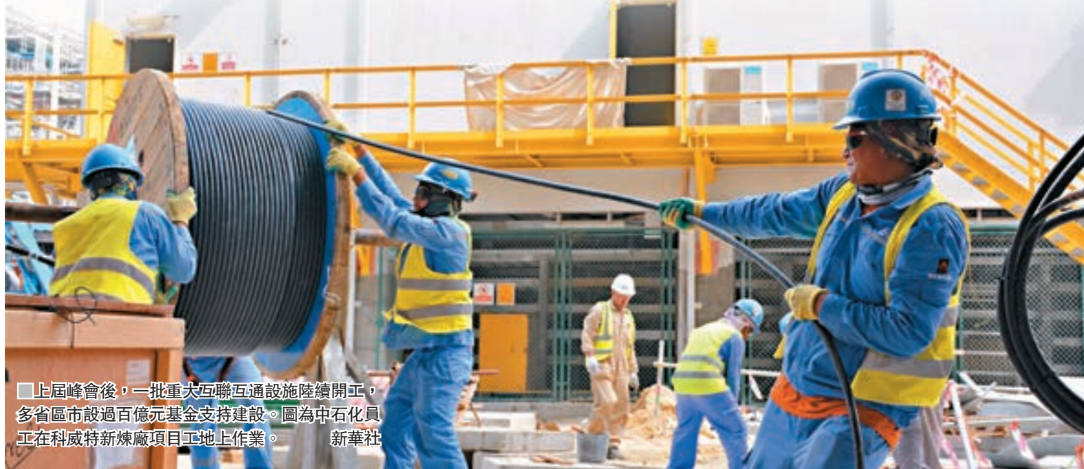
上屆峰會後，一批重大互聯互通設施陸續開工，多省區市設百億元基金支持建設。圖為中石化員工在科威特新煉廠項目工地上作業。
