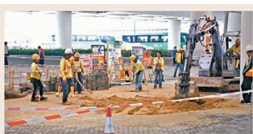
港珠澳大橋香港口岸發生爆裂事故。昨凌晨1時許，入境大堂對開地底一條水管懷疑發生爆裂，大量食水混雜泥沙不斷從地面湧出，令路面猶如變成澤國，由於凌晨時分車流較疏
