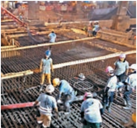
沙中線紅磡站工程弊端愈趨愈多。 資料圖片
