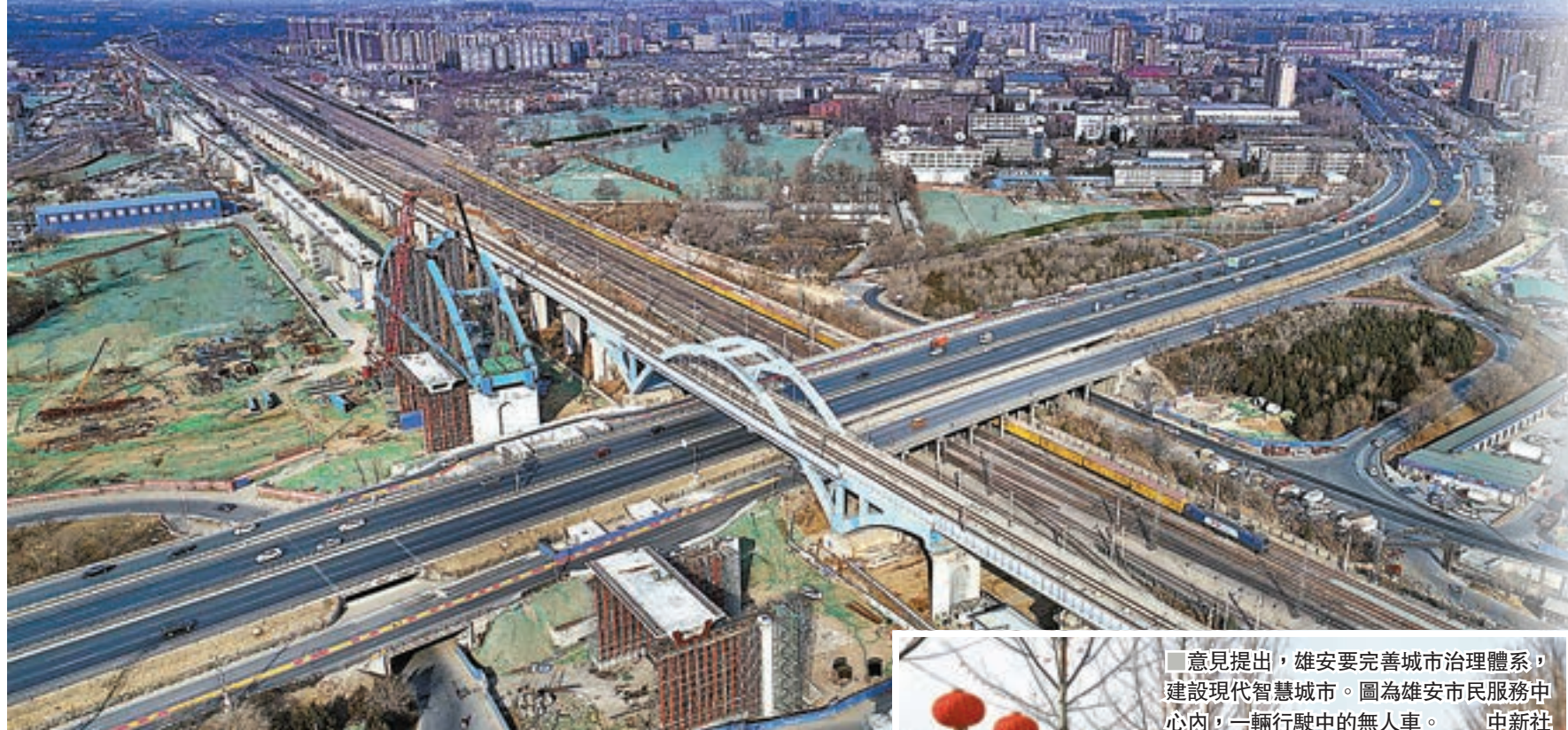
■新華社昨日受權發佈《中共中央國務院關於支持河北雄安新區全面深化改革和擴大開放的指導意見》。圖為位於北京黃村的建設中的京雄城際鐵路。 資料圖片
