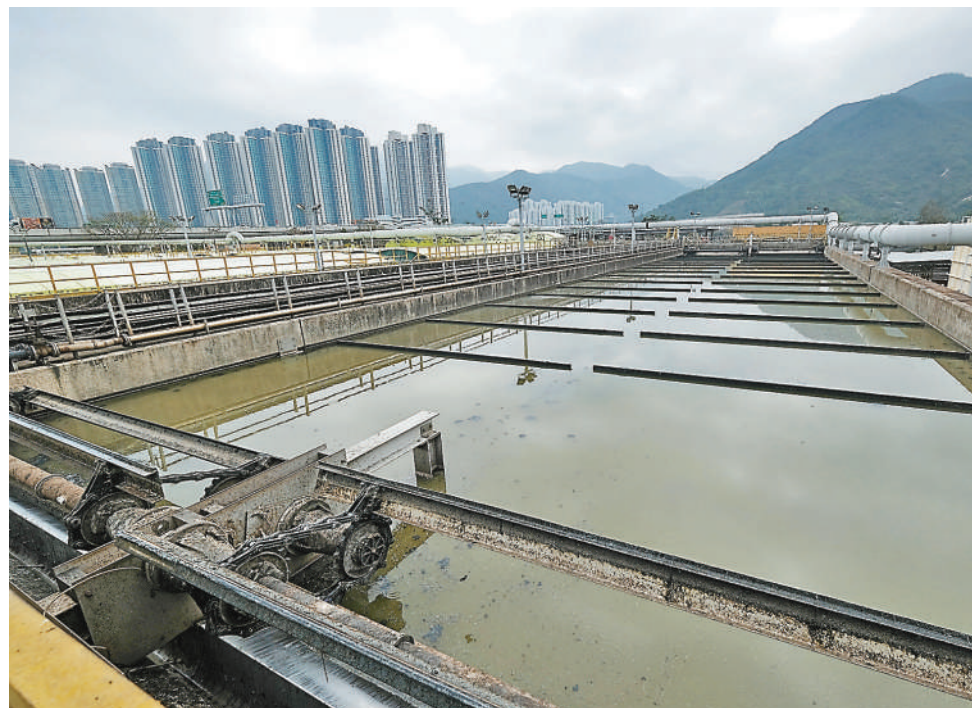
■佔地28公頃沙田污水處理廠自1982年開始運作，是全港最大的二級污水處理廠，為沙田及馬鞍山區60萬市民提供污水處理服務。 香港文匯報記者梁祖彝 攝
