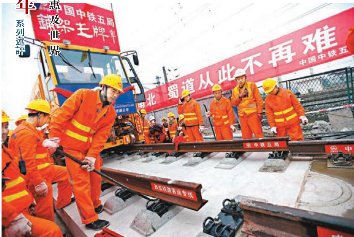
中國共產黨始終保證了改革開放的正確方向。圖為工人為四川江油火車站進行接軌作業。
