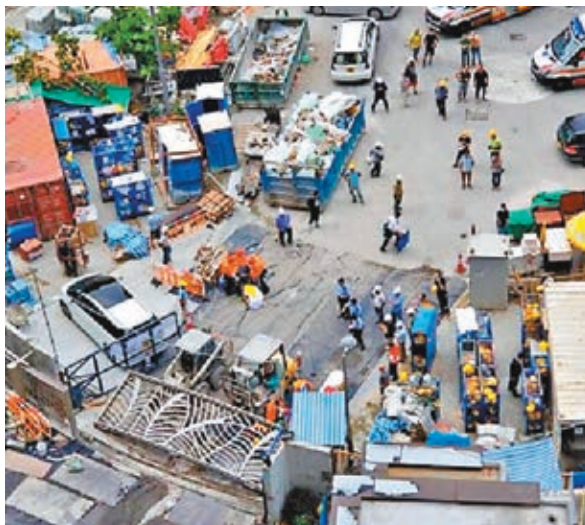
兩部剷車唧起屋苑大閘拯救被壓困工人。網上圖片
