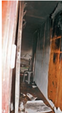
發生謀殺、自殺及縱火案的劊房單位嚴重焚毀。
