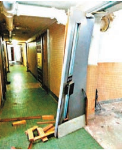
現場的確有防煙門損壞，但七成樓層防煙門毀壞就攞明係老作嘍。 香港文匯報記者劉友光 攝
