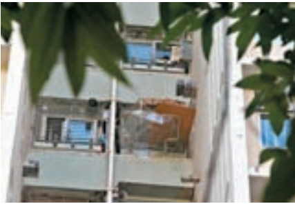
■石屎墜街現場高層有單位外牆出現石屎鬆脫情況。
