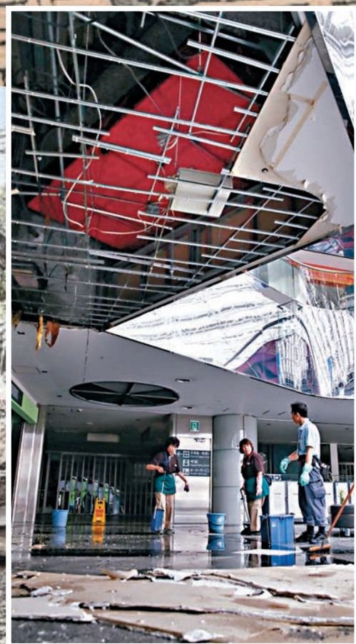
機場天花板和多處牆壁倒塌。美聯社
