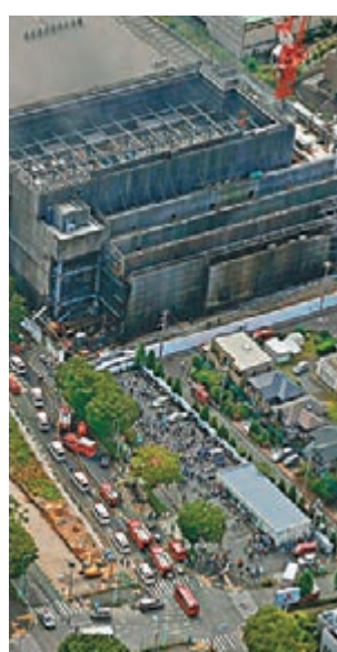
■東京西郊多摩市一個建築地盤發生大火，70多輛消防車到場灌救。美聯社
