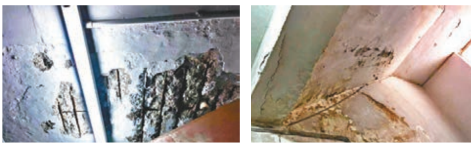
■大廈鋼筋外露。調查機構供圖 ■大廈外牆剝落。調查機構供圖
