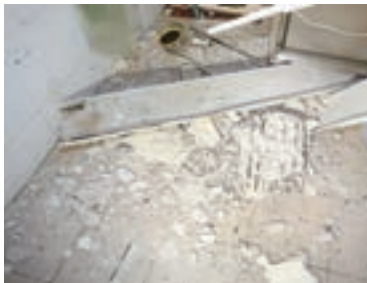
■發現天花剝落的點心店地上滿佈石屎碎及假天花組件，幸未有造成嚴重受傷。
