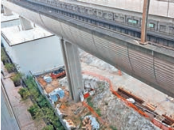
■西鐵元朗站架空路軌，其中兩座橋臺發生沉降。
