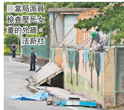
當局派員檢查壓死女童的外牆。法新社
